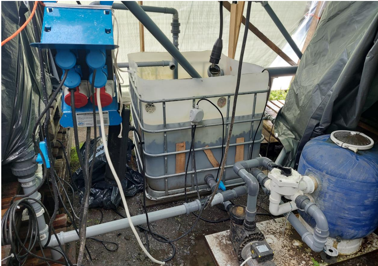
Figur 14. Reningsystemet. I mitten syns biofiltertanken, framför den cirkulationspumpen, och till höger sandfiltret (den blåa tunnan). UV-filtret, brunsvattentanken och luftningstanken finns till vänster utanför bilden (bakom svart plast).
