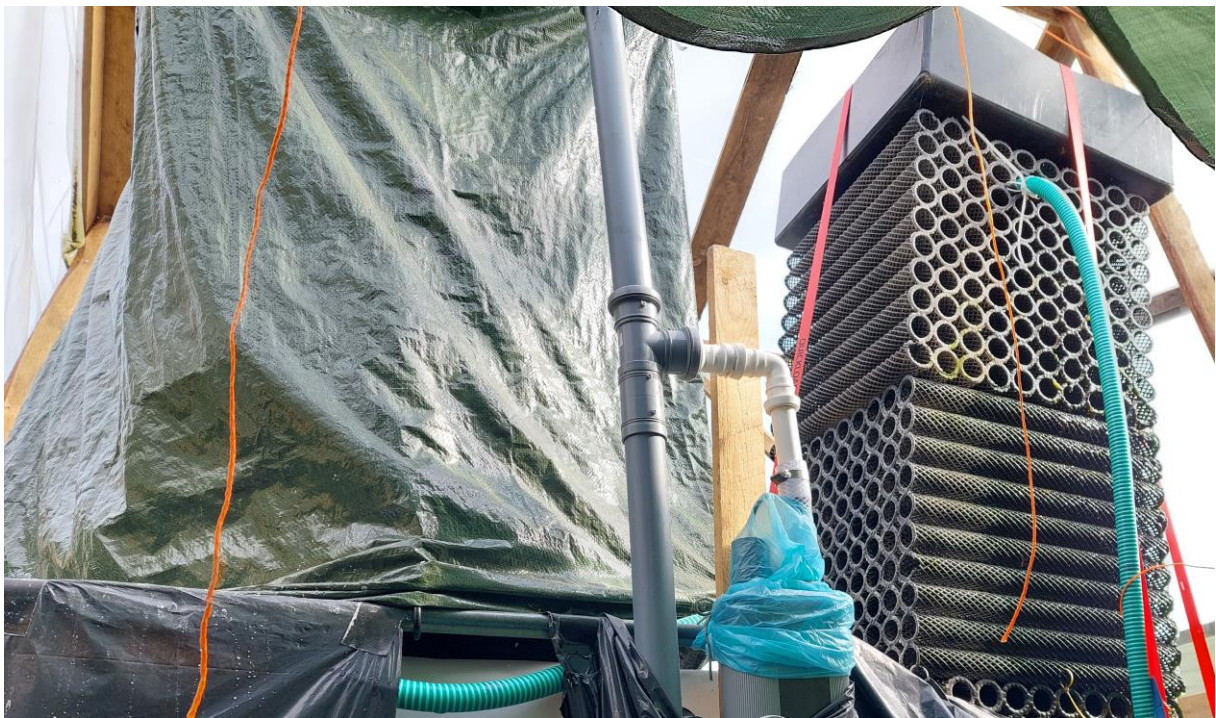
Figur 16. Luftningstornen i brunsvattentanken (till höger) och luftningstanken (till vänster). Tornet i luftningstanken är inklätt med en dubbelvikt presenning för att minska på värmesvinnet (presenningen hålls ut en bit från tornet med hjälp av en träram högst upp). Den gröna slangen till höger pumpar vatten från sänkpumpen i botten på brunsvattentanken tillbaka upp i luftningstornet.
